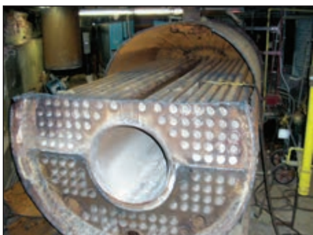
شکل ۱-۴۲ لوله‌ی چدنی دیگ بخار
