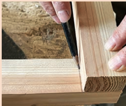
شکل ۱۱۳- خط کشی با کمک قطعه دیگر اتصال
