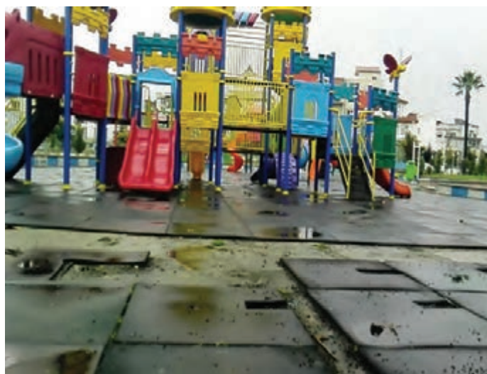
شکل ۲۳- کف پوش نامناسب زمین بازی
