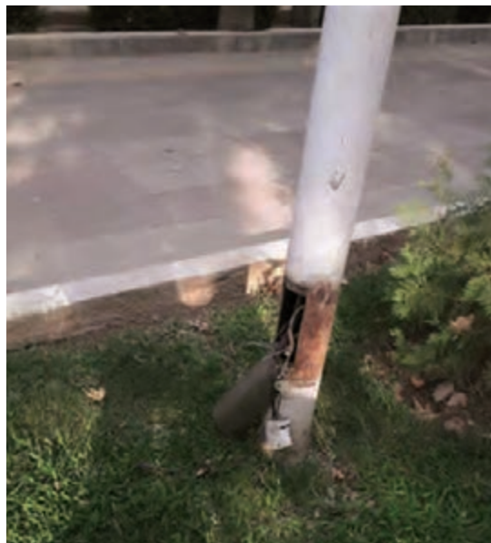
شکل ۲- وجود خرابی در سیستم برق‌کشی
