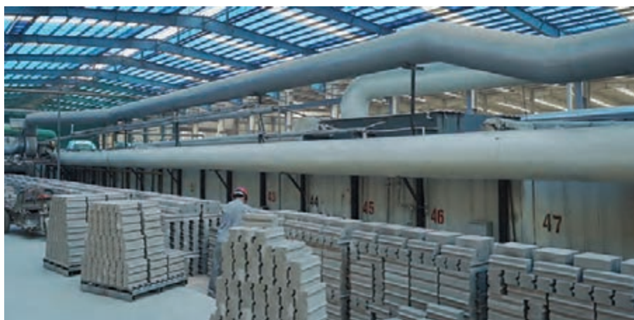
شکل ۳۶- بازیابی حرارت در کوره
