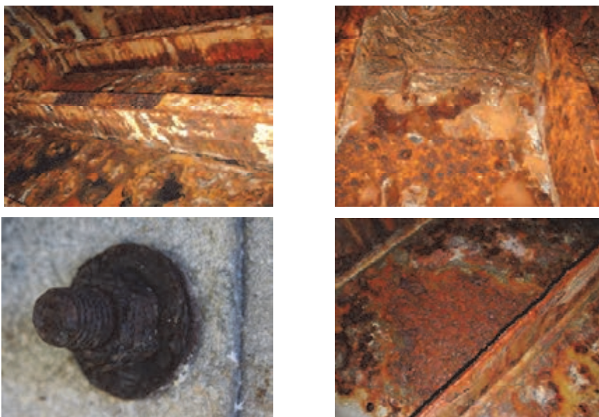
شکل ۱-۱ سطوح زنگ زده در کشتی
