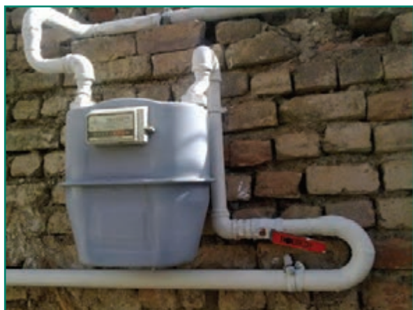
شکل ۸۱-۴ یک کنتور ۱۰ متری نصب شده
