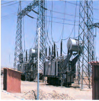
شکل (۲۸-۳) دو ترانسفورماتور موازی شده
