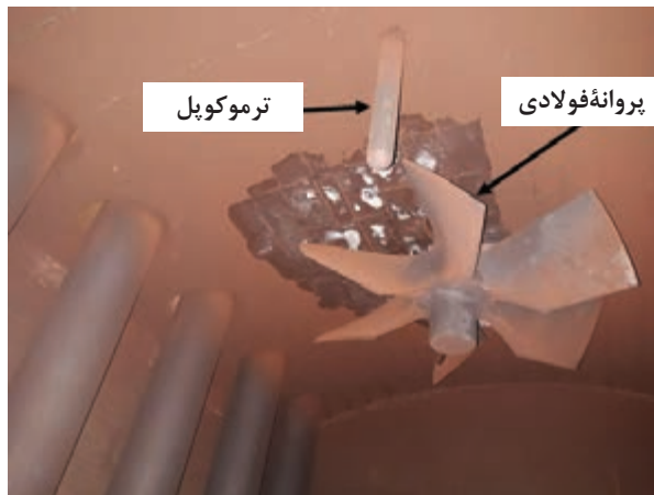
شکل ۱۴- فن گردش هوا در داخل کوره
