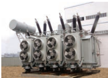
شکل (۳-۱) ترانسفورماتور خطوط انتقال
