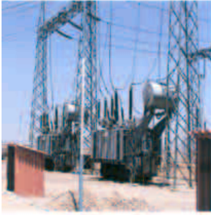
شکل (۲۸-۳) دو ترانسفورماتور موازی شده
