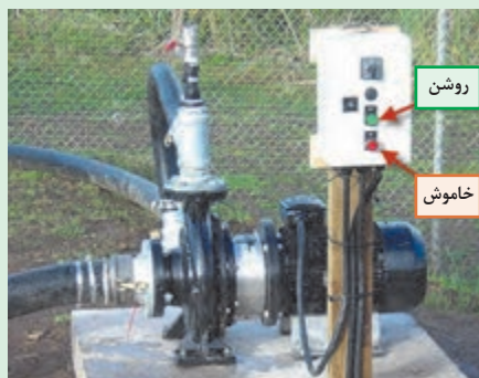
شکل ۲۸-۵. کلیدهای کنترل روی تابلو
