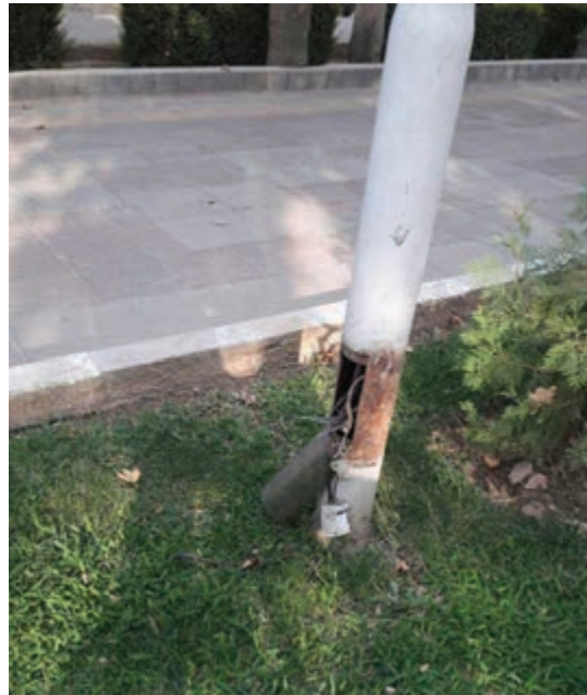
شکل ۲- وجود خرابی در سیستم برق کشی
