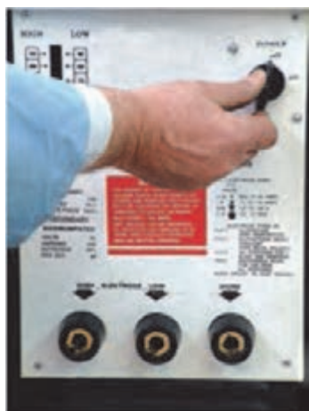
شکل ۵- نمایی از ترانسفورماتور
