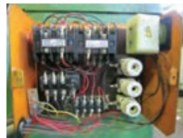
شکل ۵-۹۱ نمونه تابلوی برق دستگاه تراش
