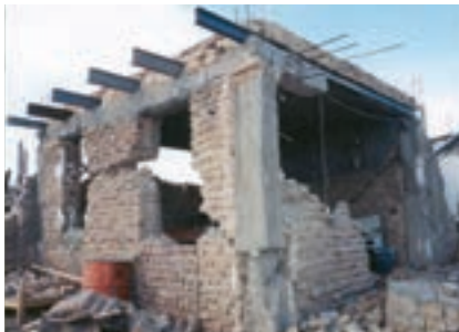
کیفیت نامطلوب بتن، عدم اجرای صحیح شناژهای افقی و قائم و اتصالات آنها موجب تخریب این سازه ی سبک و ساده شده است.
