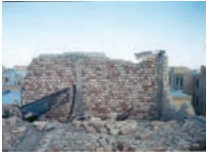
عدم رعایت طول مهاري مناسب در شناژ قائم و عدم اجرای کلاف افقی زیر سقف
