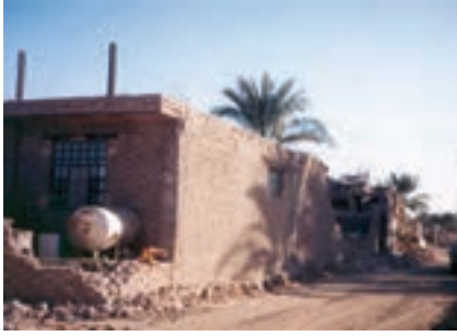
ساختمان نیمه اسکلت با شنازهای افقی و قائم که دچار کم‌ترین آسیب شده است.
