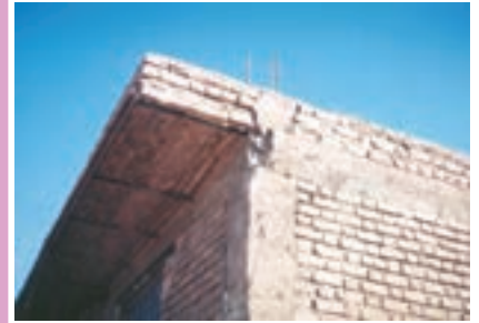
ساختمان نیمه اسکلت با شناژهای افقی و قائم که دچار کم‌ترین آسیب شده است.
