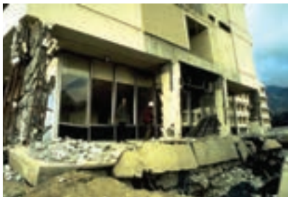
تخریب ستون‌های سازه به دلیل کیفیت نامرغوب بتن و اجرای نادرست آن
