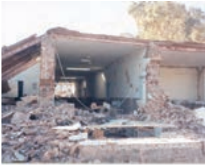
عدم اجرای شناز قائم و افقی در مدارس قدیمی، موجب تخریب آن‌ها در اثر زلزله شده است.
