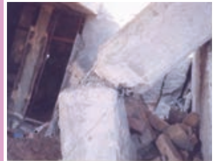
شکست ستون به علت فاصله‌ی زیاد خاموت‌ها و بتن‌ریزی نامناسب و سطح مقطع کم آرماتورهای طولی که به دنبال آن کل سازه تخریب شده است.
