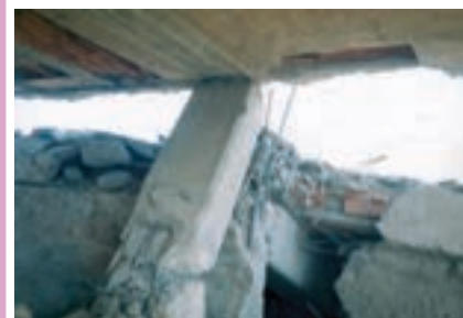
ضعف ستون و عدم اتصال صحیح به تیر بتنی موجب تخریب سازه شده است.
