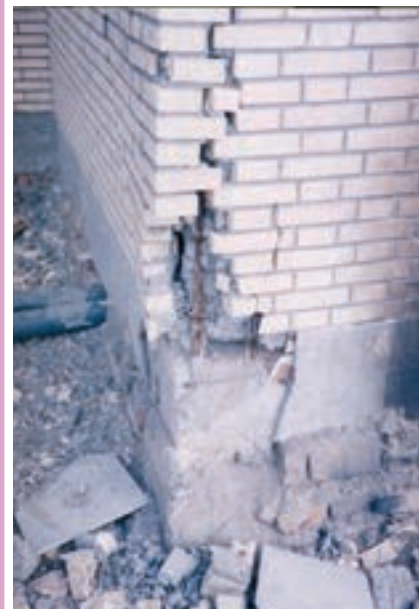
بتن‌ریزی نادرست شناژ قائم
