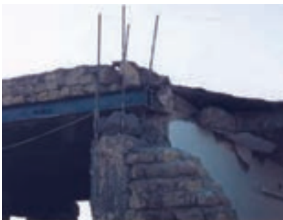
عبور آهن نعل درگاه از شناژ و عدم بتن ریزی در آن نقطه که باعث خرابی گردیده است.
