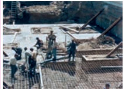
نمایی از فونداسیون نواری و مرکب از یک ساختمان مسکونی در حال بتن‌ریزی
