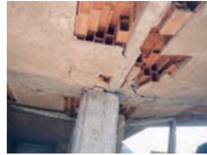
کیفیت نامطلوب بتن در تیر اصلی و عدم اتصال مناسب تیرچه‌ها به آن موجب ریزش سقف شده است.
