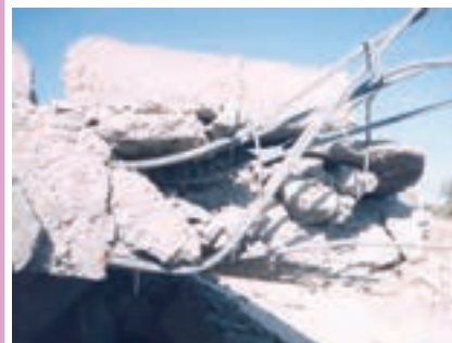
بتن ریزی نامناسب در محل اتصال موجب شده تا آرماتور به حد جاری شدن نرسد و بتن جدا گردد.
