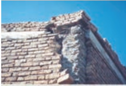
ضعف بتن ریزی در محل اتصال شناژ قائم به افقی
