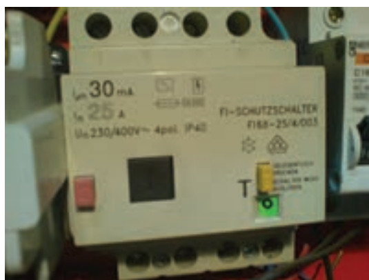
شکل ۱-۱۸- فیوز حفاظتی نصب شده در کارگاه
