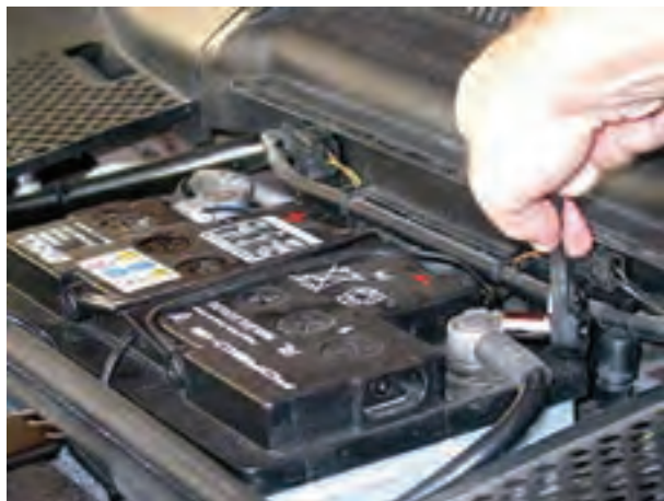
شکل ۲-۳۳- باز کردن اتصال بدنه‌ی باتری
