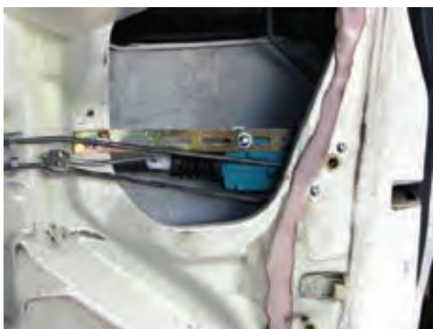
شکل ۳۷-۲- نحوه‌ی اتصال عملگر الکتریکی
