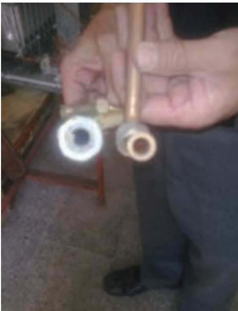
شکل ۱۲-۵- تشکیل رسوب در لوله آب گرم
