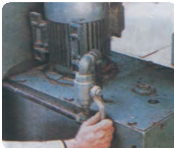
شکل ۷۶-۵ الکتروپمپ و کارترو روغن پرس هیدرولیک
