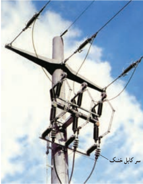
شکل ۶-۶- سر کابل خشک حرارتی هوایی
