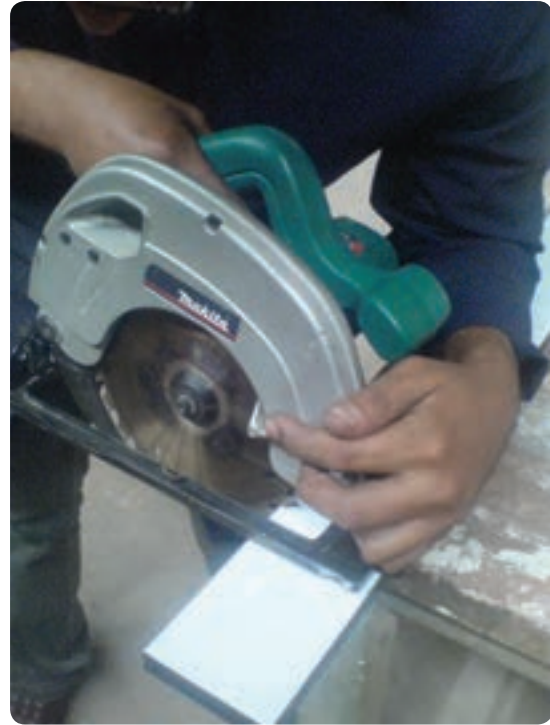
شکل ۲۸-۲ بیانگر رعایت نکردن اصول ایمنی در برش قطعه کار بدون بکارگیری گونیا یا بر راستی است
