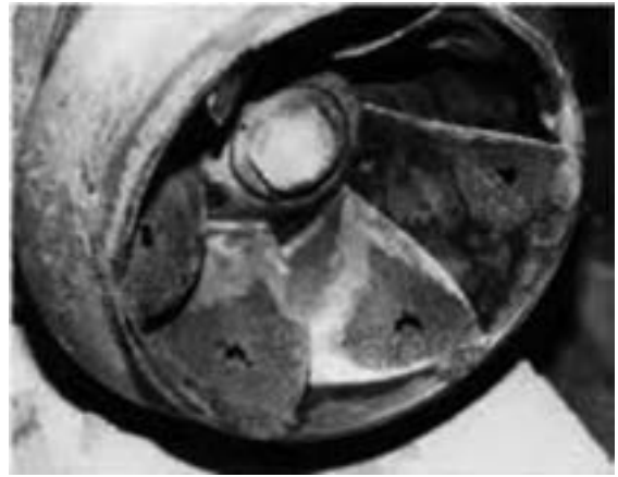
شکل ۶-۲۲- حفره‌های ایجاد شده
