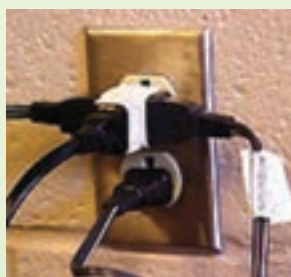
شکل ۲۳-۲- انشعاب غیر استاندارد از پریز برق
