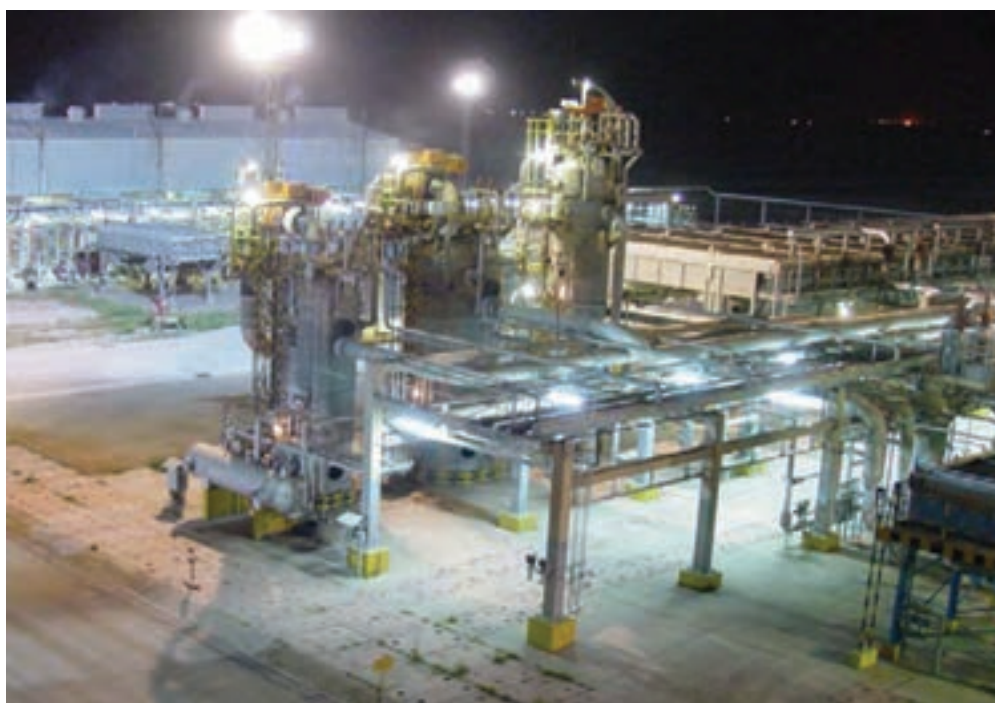
شکل ۳۱-۵ کارخانه گاز و گاز مایع شماره ۹۰۰- اهواز
