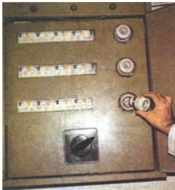
شکل ۲۸-۲- تابلوی برق توزیع داخلی و فیوزها و کلید قطع و وصل مربوطه
