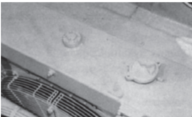
شکل ۹۷-۶ - بازدید سیستم خنک‌کننده از نظر نشستی
