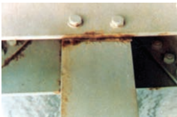
شکل ۶-۴ - آسیب دیدگی در قسمت درزهای محل اتصال
