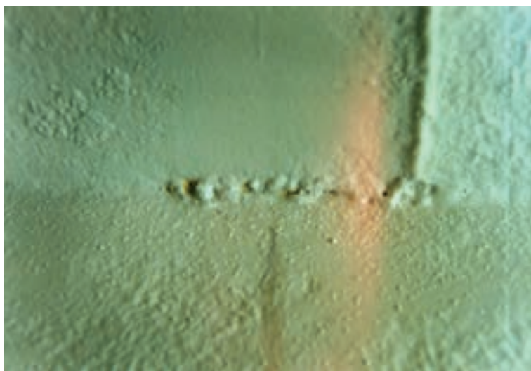
شکل ۶-۳ - جوش کاری و آماده سازی نامناسب
