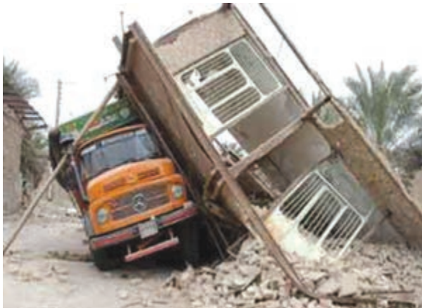
(د) ریزش دیوار در اثر زلزله
