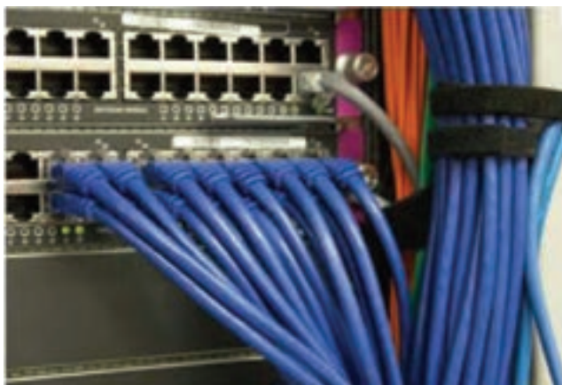
شکل ۲۵-۴- اتصال کابل‌ها به پیچ پانل
