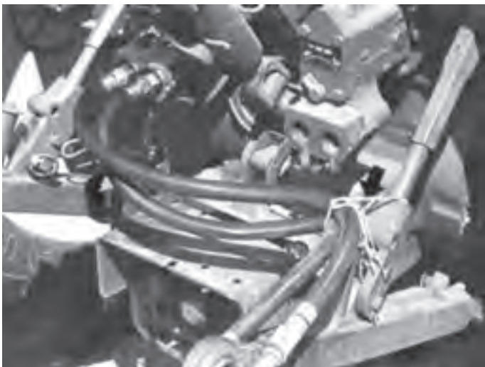
شکل ۱۳-۶- مهار نامناسب شیلنگ‌های هیدرولیک
