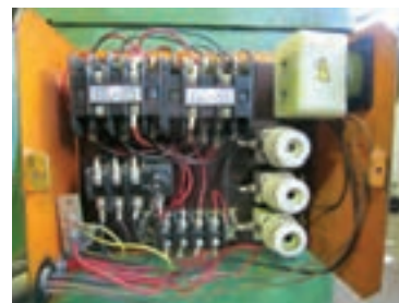
شکل ۵-۹۱ نمونه تابلوی برق دستگاه تراش
