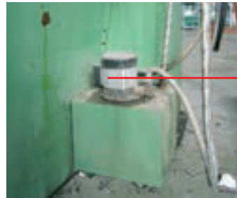
الکتروپمپ آب صابون در دستگاه تراش
