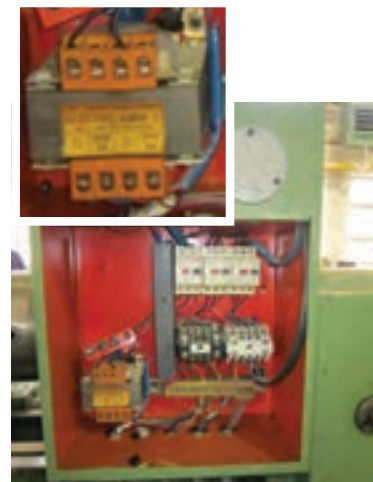
شکل ۴-۱۳ ترانسفورماتور در تابلوی برق دستگاه تراش.
