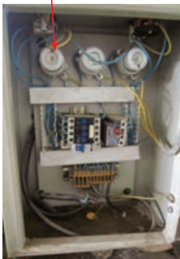
(ب) تابلو برق اره لنگ
