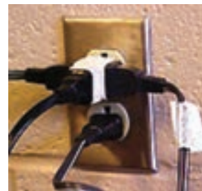
شکل ۲-۱۷ انشعاب غیر استاندارد از پریز برق.
