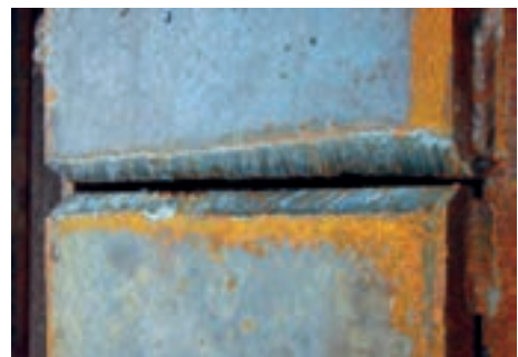
آماده‌سازی نامناسب درز جوش شیار
