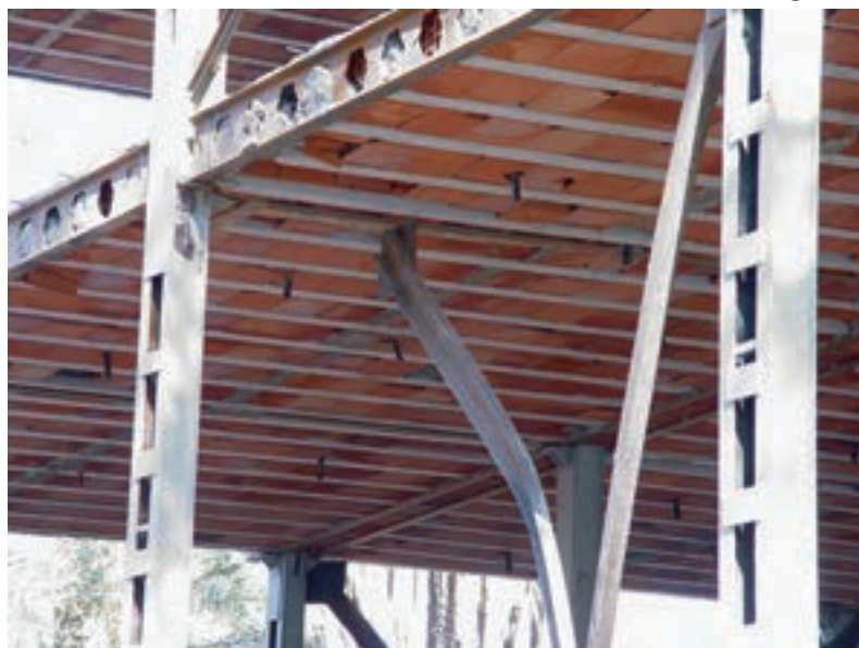
شکل ۱-۱۲- گسیختگی جوش در زلزله به
