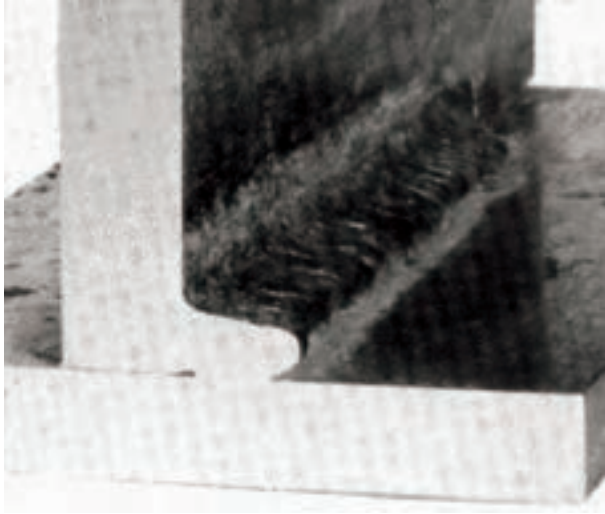
شکل ۱۲-۱۵- سرفتنگی در یک جوش گوشه
