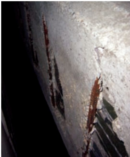
استفاده از پوشش بتنی در یک سازه صنعتی که بطور مناسبی اجرا نشده است.
