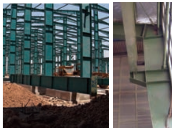
فلنج انتظار در ساختمان صنعتی
