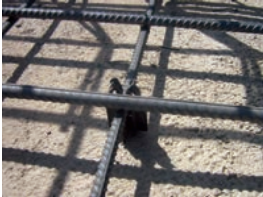
شکل ۳-۱۱- استفاده از فاصله انداز (Spacer) جهت فاصله دادن آرماتورهای کف با بتن مگر
