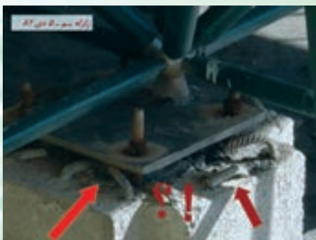
نمونه ای از اتصال نامناسب سازه به صفحه ستون در زلزله بم
