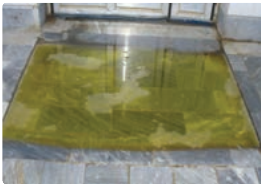
شکل ۱۱-۱- تعبیه حوضچه ضدعفونی در مدخل سالن مرغداری
