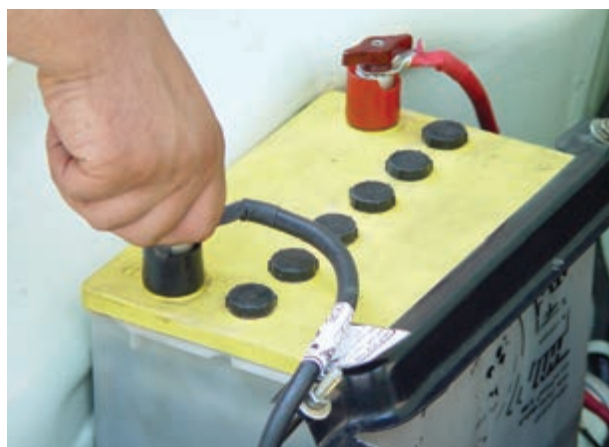
شکل ۱-۴۹- باز کردن اتصال بدنه باتری
