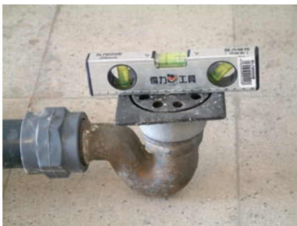
کف‌شوی نصب شده بر روی سیفون شترگلی
