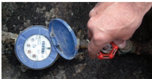
شکل ۱۴۰-۲ بستن شیر فلکه‌ی اصلی
