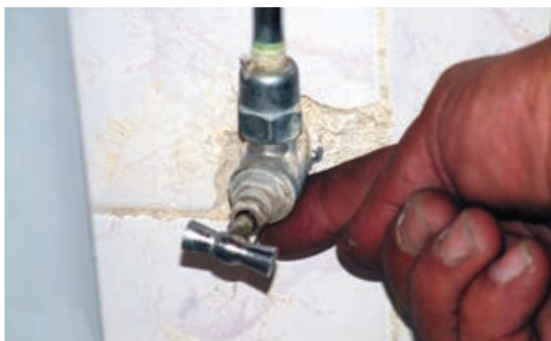
شکل ۱۴۷-۲- کنترل نشت آب از محل اتصال
