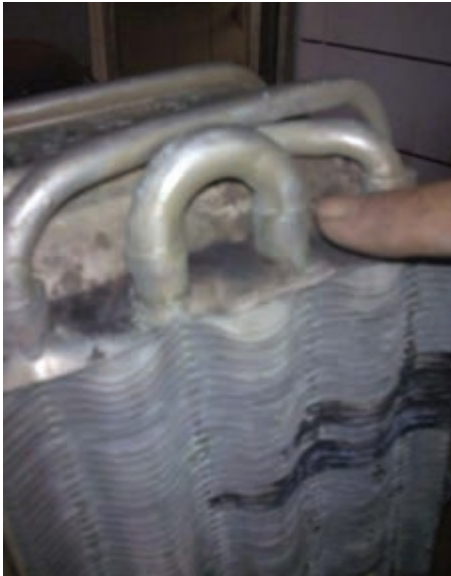
شکل ۱۱-۵- تشکیل رسوب در آب گرم‌کن
