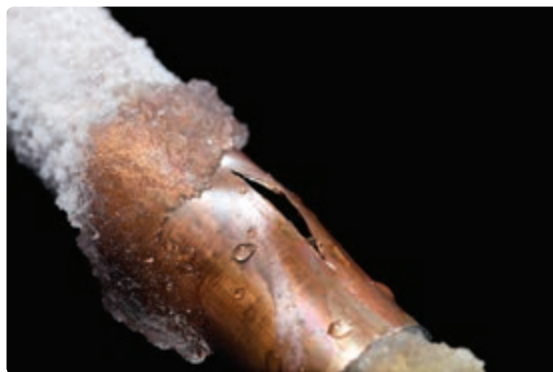
شکل ۶-۵- شکستن لوله آب در اثر انجماد آب
