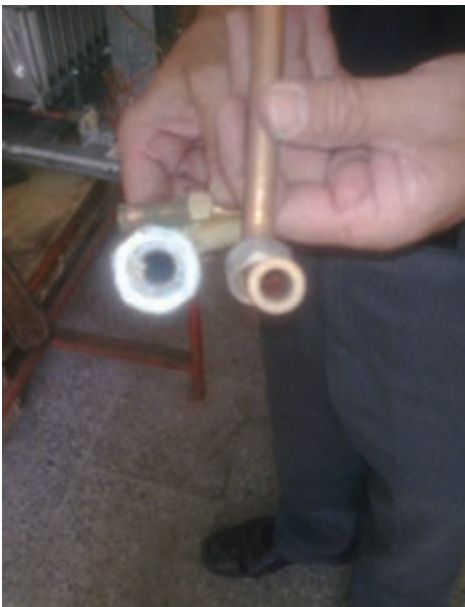
شکل ۱۲-۵- تشکیل رسوب در لوله آب گرم
