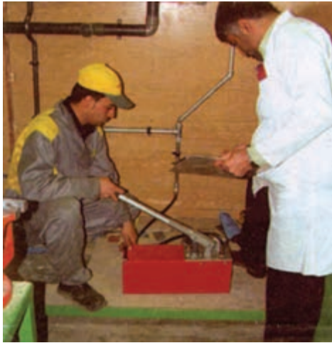
شکل ۵-۹۳- نحوه‌ی آزمایش با پمپ آزمایش دستی
