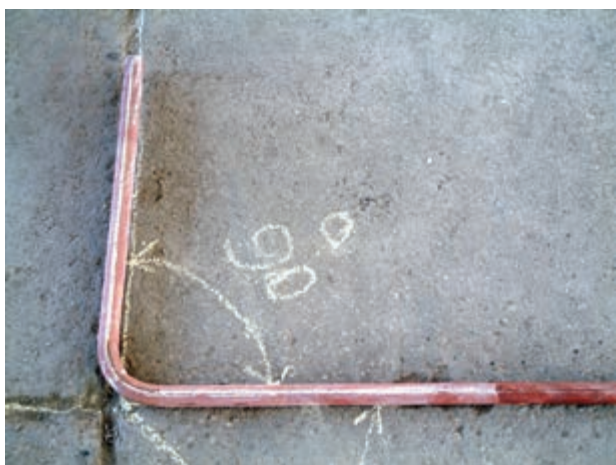
شکل ۳-۵۷- لوله‌ی خم کاری شده
