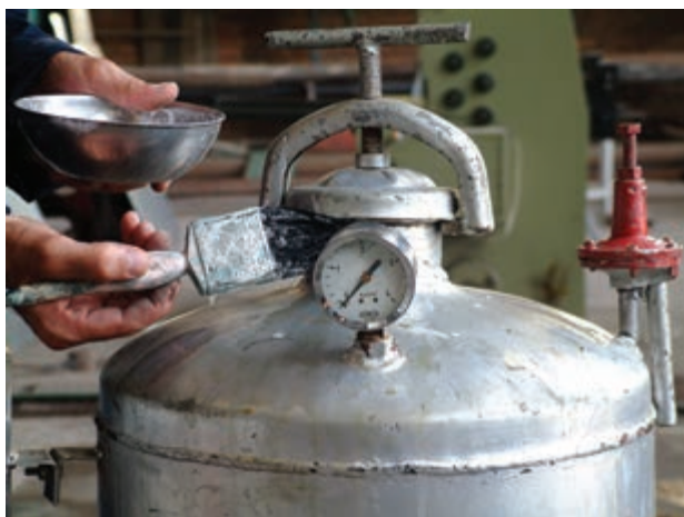
شکل ۲-۳۸- کنترل نشستی گاز
