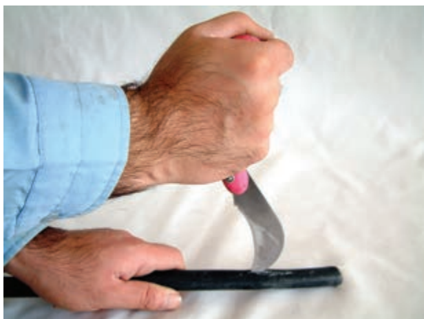
الف - نحوه‌ی غلط لخت کردن کابل
