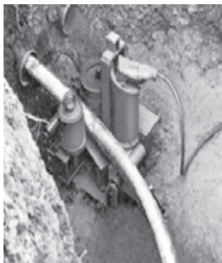
شکل ۵-۵۱- دستگاه کشش کابل
