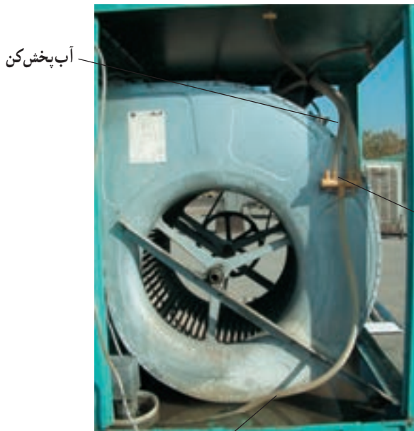
شیلنگ‌های آب پخش‌کن
