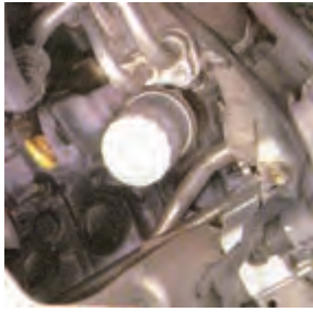
شکل (۲-۶۰) کنترل فیلتر از نظر نشتی
